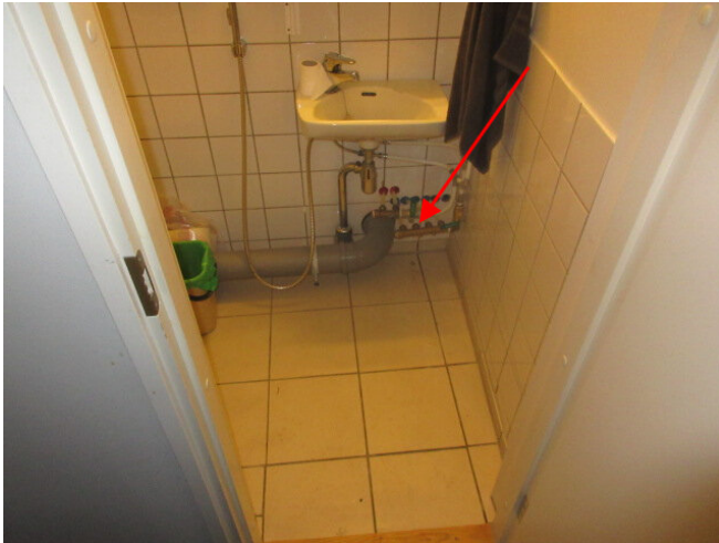
Vuotokohta henkilökunnan vessassa jakotukissa.
