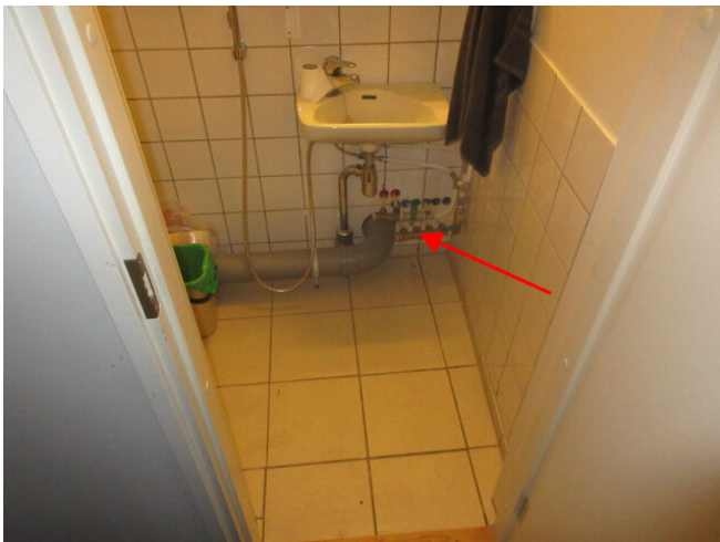
Henkilökunnan wc. Vuotokohta nuolella merkitty.
