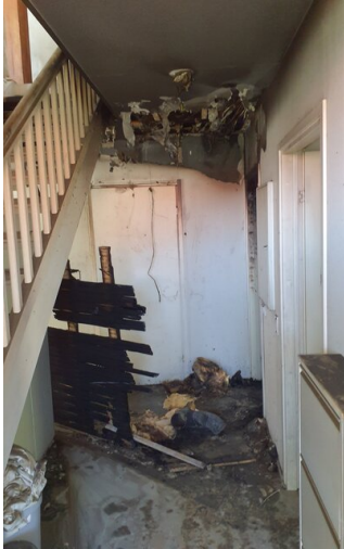
Alakerran eteinen, lattialla vettä. Palo ja nokivahinkoa lisäksi.
