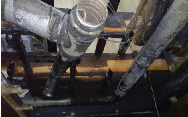
Kuvaa pesuhuoneen katosta. Kantavat palkit palanut pahasti
