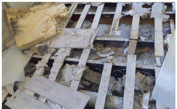
Yläkerran makuuhuoneen lattia
