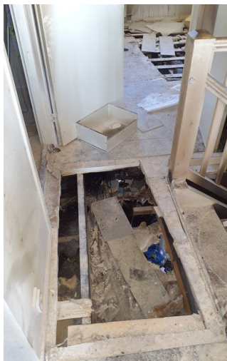
Yläkerran lattia osin auki.
