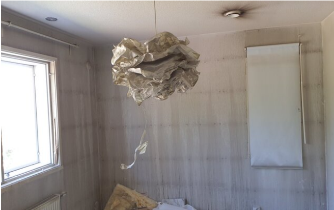
Makuuhuoneen katto ja seinät noessa.
