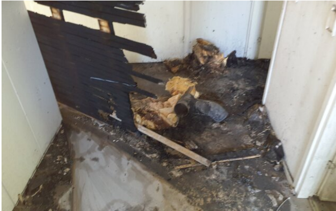
Eteisen lattia, vesimärkä.
