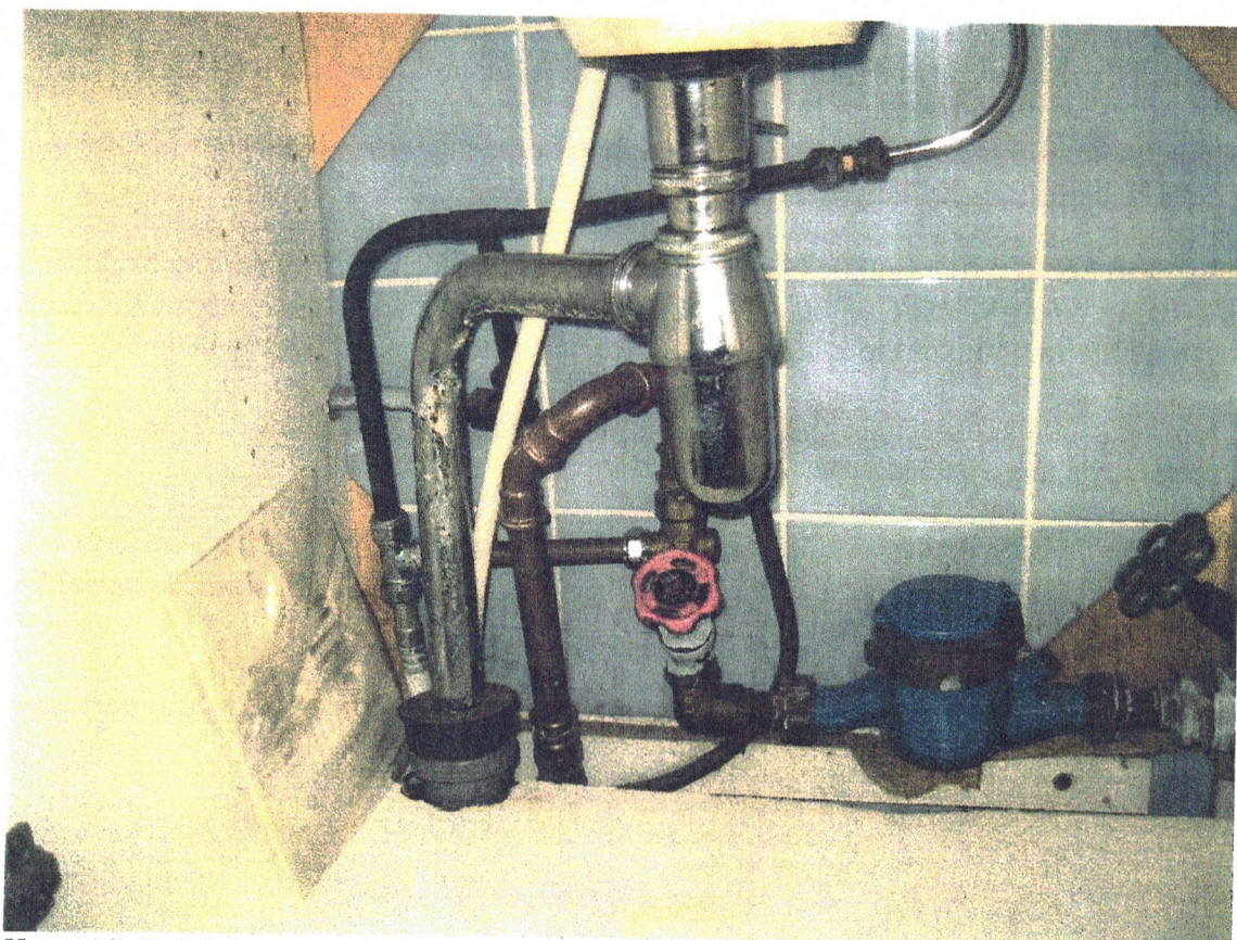
Kuva 10. Talojohto ja vesimittari on pesuhuoneen alakaapistossa.
