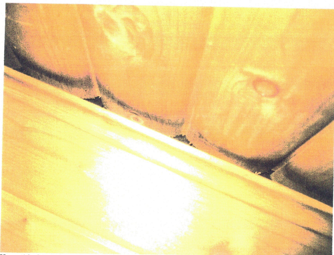
Kuva 13. Saunan vaakapaneloinnin takana näyttää olevan vanha pystypanelointi.
