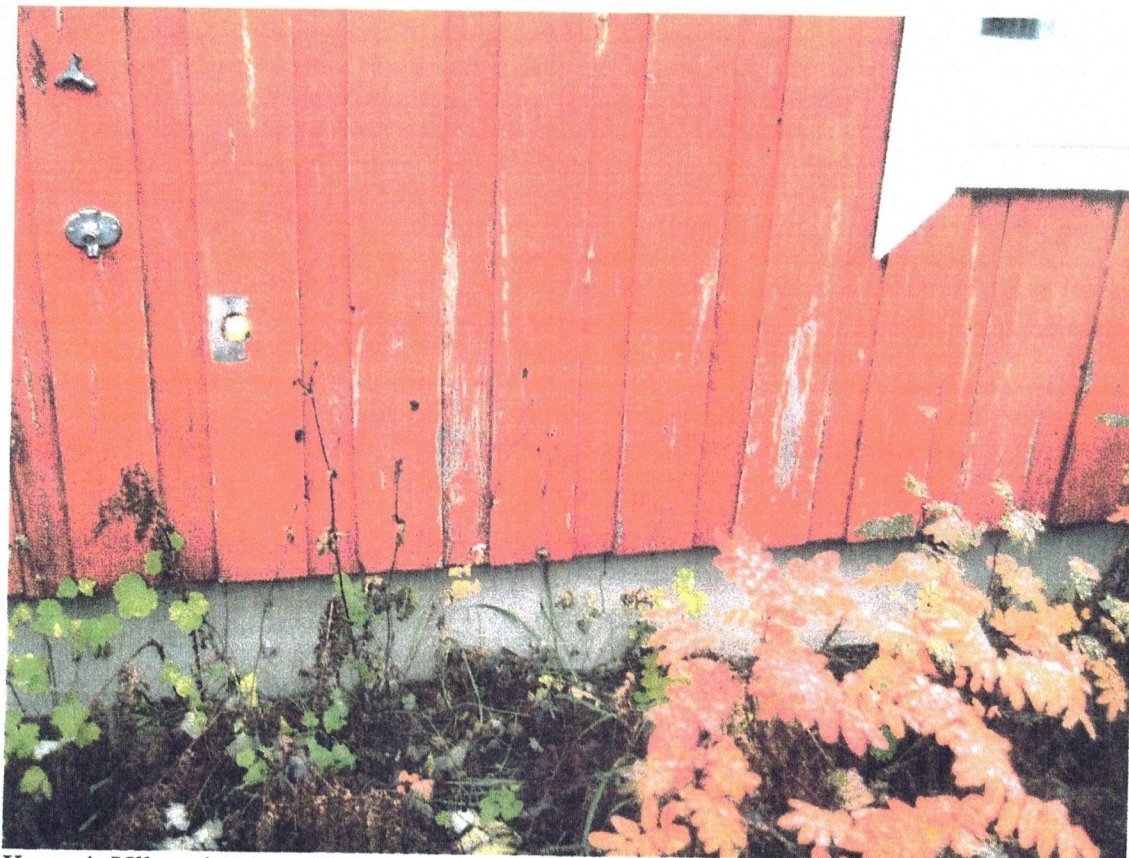
Kuva 4. Ulkoseinän maalipinta on paikoin kulunut ja irti alustastaan
