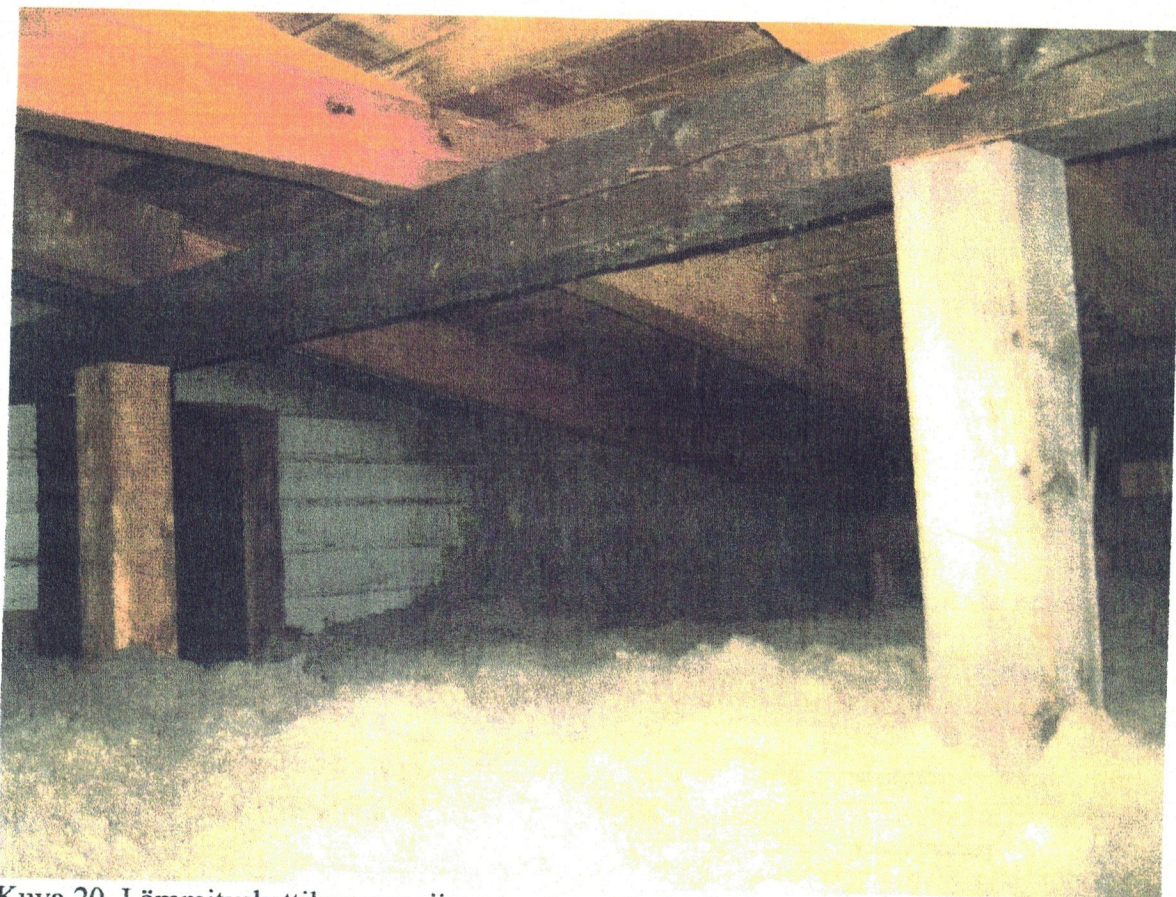
Kuva 20. Lämmityskattilan savupiippu on muurattu laajennusosaan.
