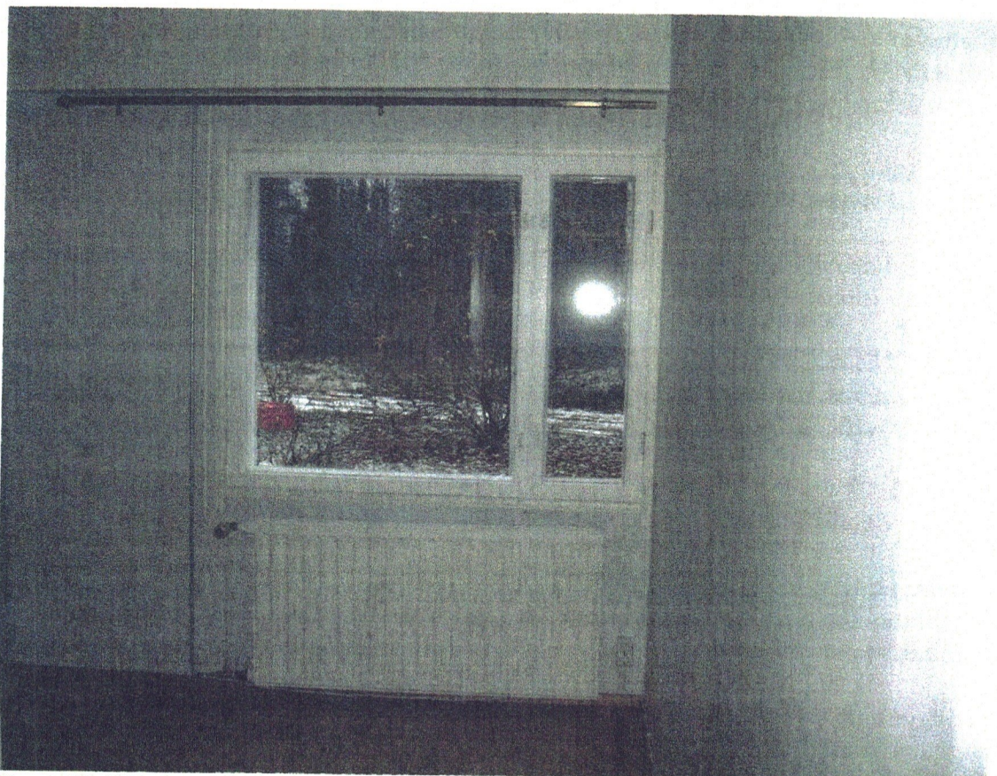
Kuva 23. Lämmönjakojärjestelmää on uusittu vaiheittain rakennuksen elinkaaren aikana.
