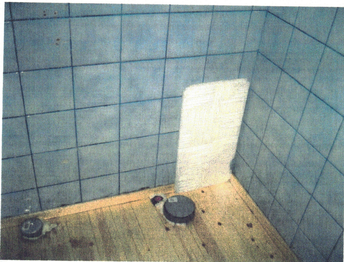
Kuva 19. Eteläpään toisen makuuhuoneen yhteydessä oleva wc on poistettu käytöstä
