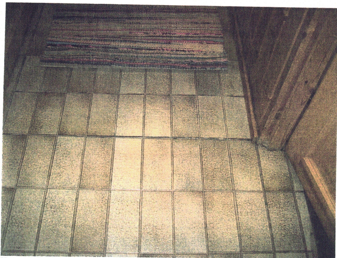
Kuva 17. Pohjoispään käytävän lattialaatoitus on halkeillut.
