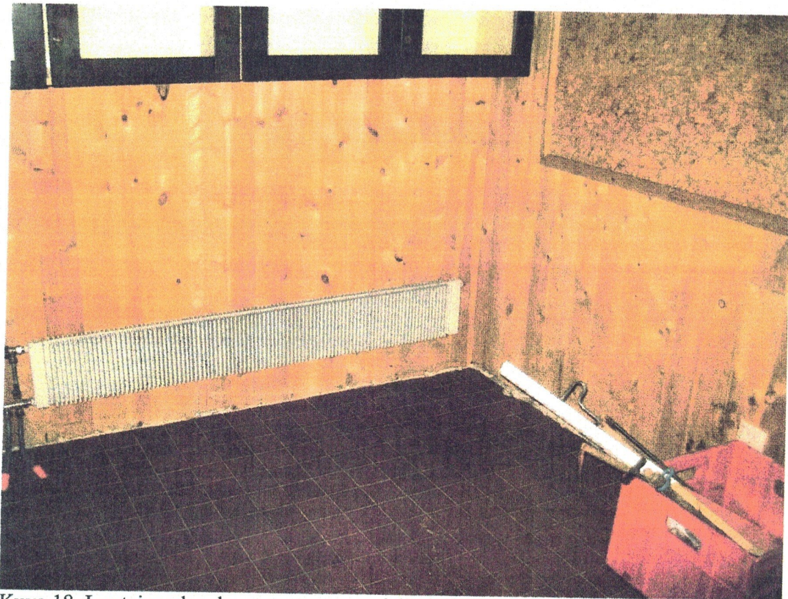
Kuva 18. Luoteisnurkan huoneesta puuttuu jalkalistat.
