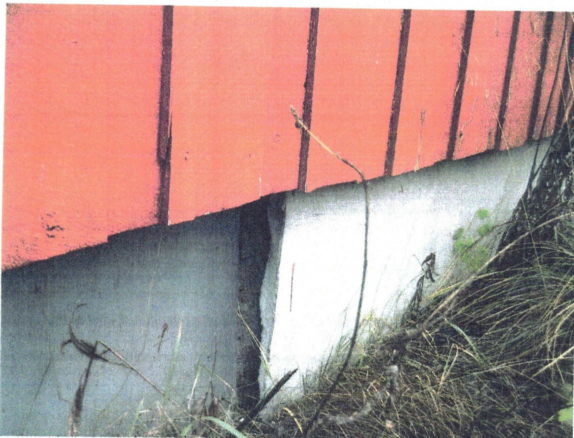
Kuva 1. Rakennukseen on tehty sokkelin eristystä styroxilla. Styrox osuus on verhoiltu lujalevyllä.
