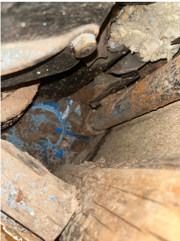
Timo Ilola 04.11.2024 14:25 Vanhoja vuotojälkiä
