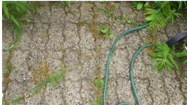
4. Rikkinäisiä laattoja rakennuksen vierustalla takapihan puolella
