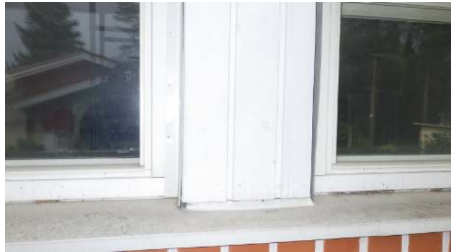
16. Rakoa ikkunan vesipellin ja seinän liittymäkohdissa
