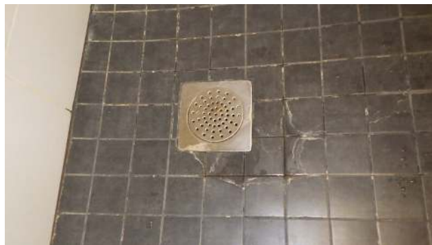
34. Lanttokohta pesuhuoneen lattiassa
