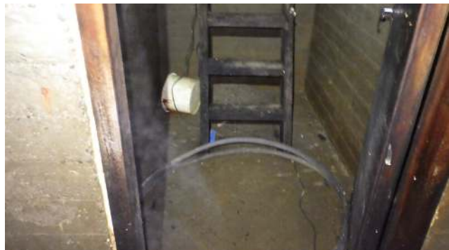
8. Kosteusvaurioita kellarin puuosissa
