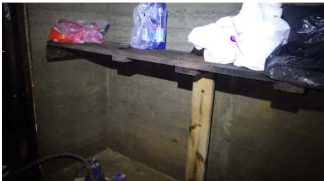
7. Kosteusvaurioita kellarin puuosissa
