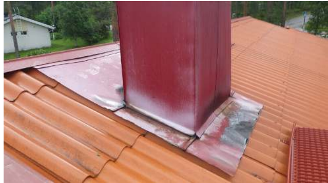
26. Vaurioita savupiipun kauluspellissä
