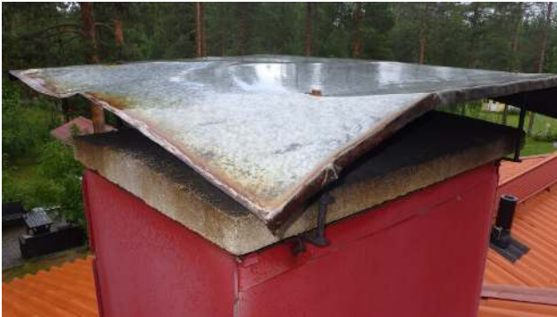
25. Vaurioita savupiipun sadehatussa
