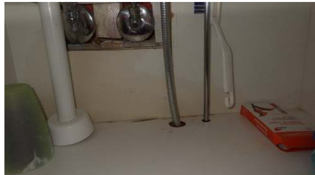
42. Kosteuden aiheuttamaa tummumaa allaskaapin pohjalevyssä ja taustalevyssä
