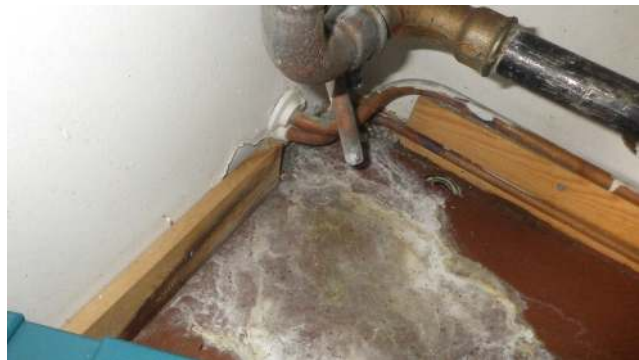
50. Vaurioita teknisen tilan seinässä ja lattiassa
