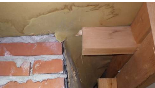
27. Kosteusjälkiä aluskatteessa rakoa savupiipun ja aluskatteen liittymäkohdassa. Savupiippua on rappaamatta.
