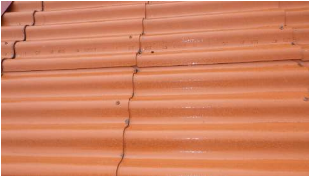
23. Kiinnitysruuvi on osittain irronnut
