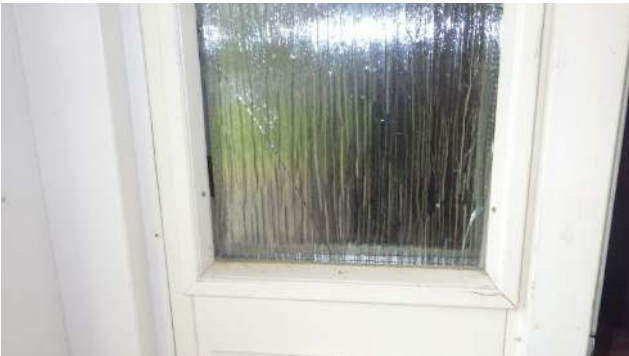
17. Pääsisäänkäynnin ulko-oven ikkunalasi on rikki
