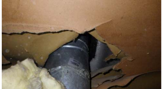
32. Ilmanpoistokanavaa on lämmöneristämättä. Rakoa aluskatteen ja ilmanpoistopiipun liittymäkohdassa
