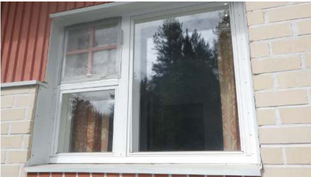
15. Rakoa ikkunan vesipellin ja tiiliverhouksen liittymäkohdassa
