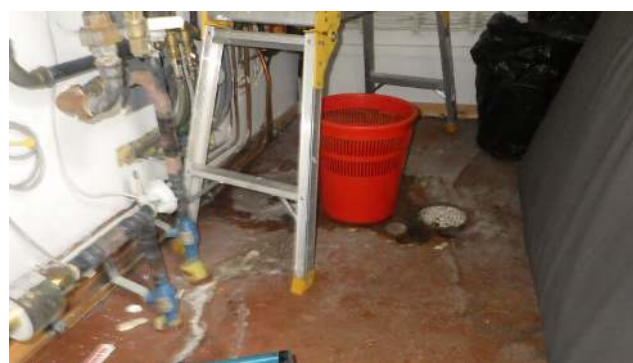
48. Vettä teknisen tilan lattiassa
