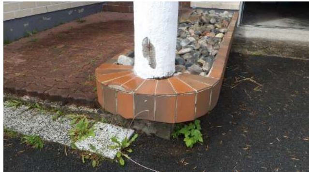
6. Vaurioita pääsisäänkäynnin läheisyydessä olevassa pilarissa ja laatoissa
