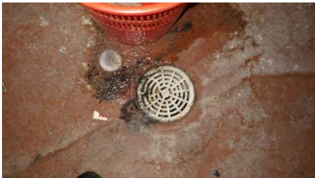
51. Vettä teknisen tilan lattiassa
