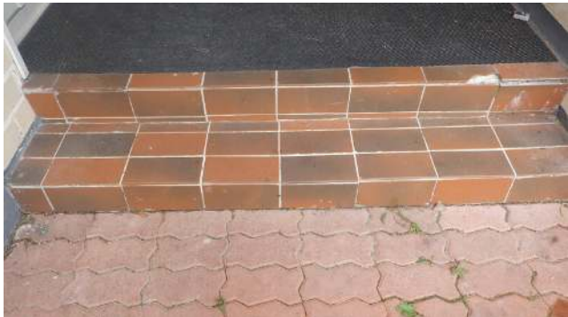
5. Vaurioita pääsisäänkäynnin portaissa
